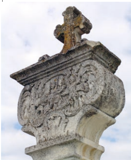
Schönberg, Sandsteinstele, Detail, Schadensbild vor der Restaurierung
