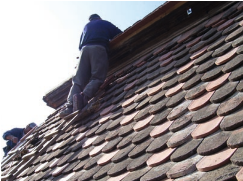
Ernstbrunn, Schloss, Detail eines Daches, bei dem alte Dachziegel wieder verwendet und mit neuem Material ergänzt werden.
