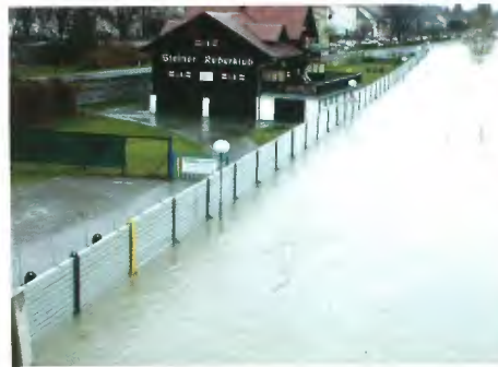
Mobiler Hochwasserschutz Donau / Krems – Stein
